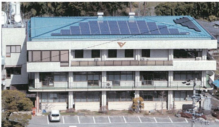
■役場庁舎に設置された「太陽光発電」
