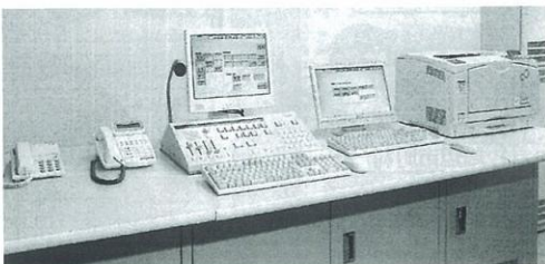
▲情報の伝達・収集及び防災行政無線の運用・管理を行う設備
