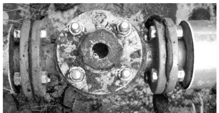
(水道管の劣化)
